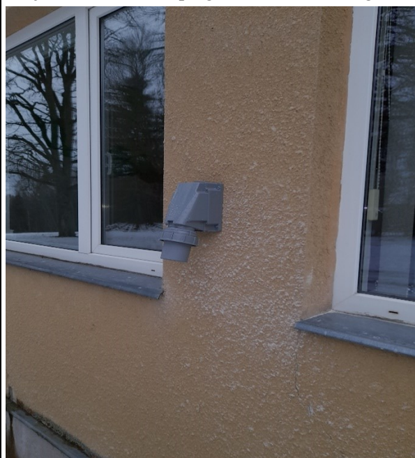
Generaatori ühendamise jõupesa hoone seinal.
